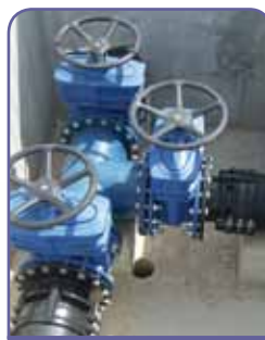
Тепловая электростанция Martigues, Франция, Марсель, AquaGrip
